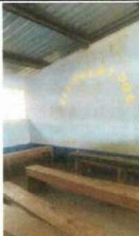
Foto 3: pintura de aulas ya que se encuentran sucias y deterioradas en las aulas y dirección.
