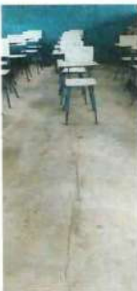
Foto 9: el piso de las aulas se encuentra en mal estado ya que se fue arruinando con el pasar de los años.
