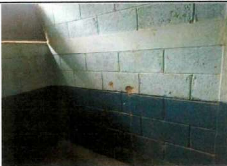
Foto 5: pintura de aulas ya que se encuentran sucias y deterioradas en las aulas y dirección.
