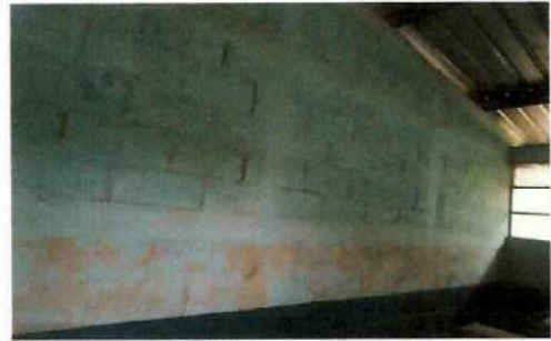
Foto 2: pintura de aulas ya que se encuentran sucias y deterioradas en las aulas y dirección.
