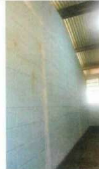
Foto 4: pintura de aulas ya que se encuentran sucias y deterioradas en las aulas y dirección.
