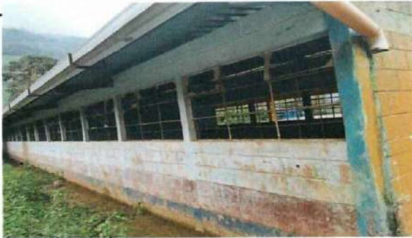
Foto1: Se observa el deterioro de los ventanales del establecimiento, el cual es de material muy delgado y ya se encuentra oxidado desde hace varios años.
