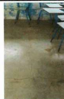
Foto 6: el piso de las aulas se encuentra en mal estado ya que se fue arruinando con el pasar de los años.
