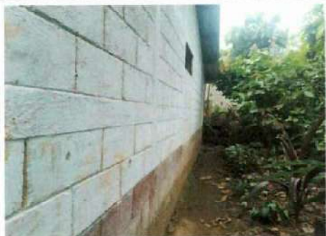
Foto 13: Se observa que las bajadas de agua ya no son funcionales y es necesario sustituir algunos canales picados por oxido.
