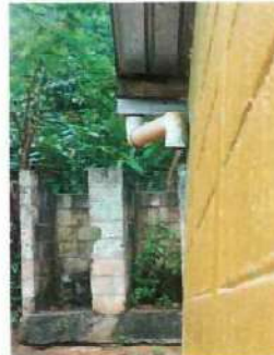
Foto 10: Se observa que las bajadas de agua ya no son funcionales y es necesario sustituir algunos canales picados por oxido.
