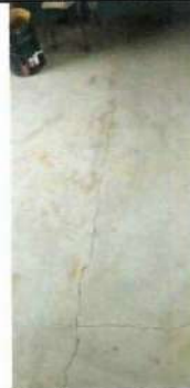
Foto 8: el piso de las aulas se encuentra en mal estado ya que se fue arruinando con el pasar de los años.
